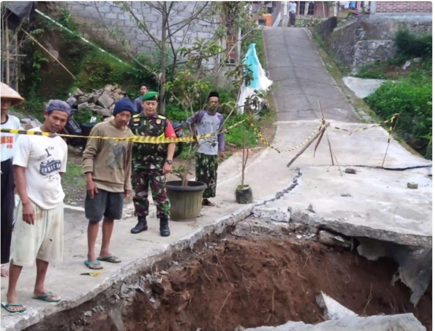
Peltu Cahyo N saat melihat kondisi jembatan yang terkena tanah longsor.
